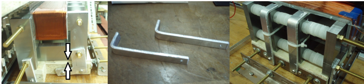
Figura 4.28: Falha e Estrutura em 'L' para Correção
